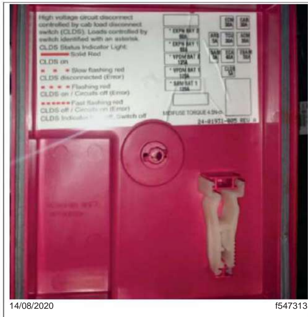
Fig. 11.6, Ejemplo de etiquetado de fusibles en la cubierta BCA
