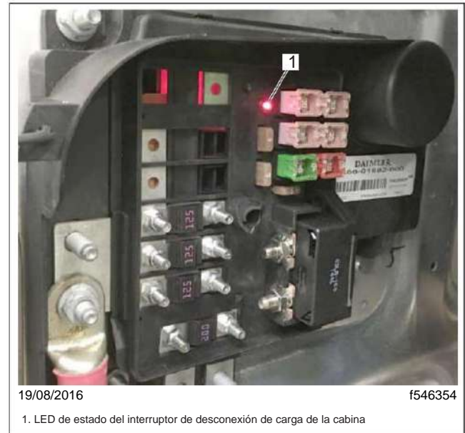
Fig. 11.10, Caja de acceso al cable de la batería (lado del motor)
